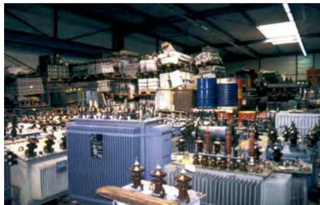
Рис. 2. Электрооборудование с ПХБ.
