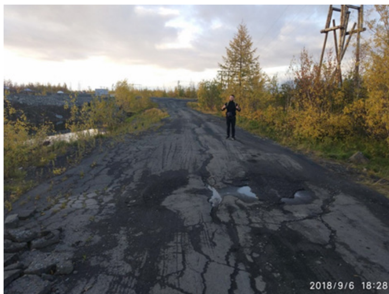
Рис. 3. Деформация дорожного покрытия в результате развития термокарста и вытаивания полигонально-жильных льдов под насыпью дороги (фотография Толманова В.А., сентябрь 2018 г.).
